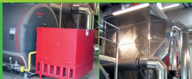
Der Spitzenlast- und Reservekessel kann bei einer erforderlichen Mehrleistung zugeschaltet werden.
