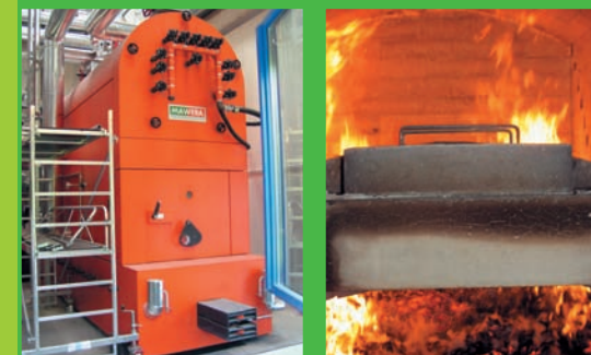
Mittels Querförderer gelangen die Holz hackschnitzeln direkt in den Biomassekessel.
